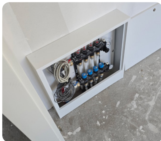
Beschermbak rond de leidingen van de vloerverwarming.
