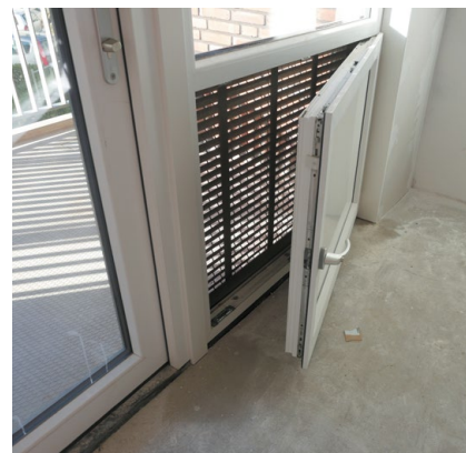
Extra ventilatieluik bij de woningen op de verdiepingen.
