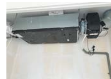
Links de warmte terugwin installatie en rechts de verdampingskoeler.
